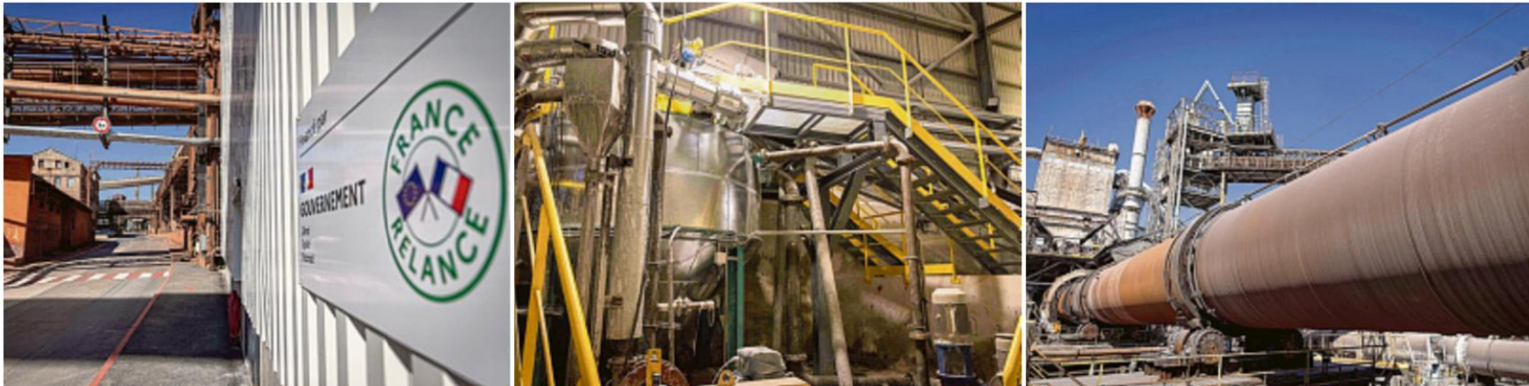
Alteo bénéficie du plan France relance. Il lui a permis d'utiliser directement l'hydrate d'alumine à partir d'un lait qui, après repos, sera calciné dans des fours. Le site conserve les anciens et dispose d'une capacité de 600 000 tonnes.
